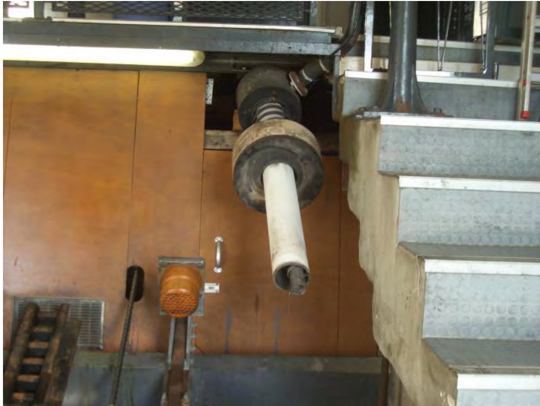
©Bloch09-Bergstation, Wasserfassung (Ballast)
