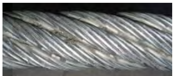
Photo 4.26 : Stries sur un câble tracteur
