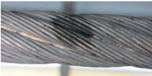
Photo 4.4 : Impact de foudre 1,5 x diamètre du toron
