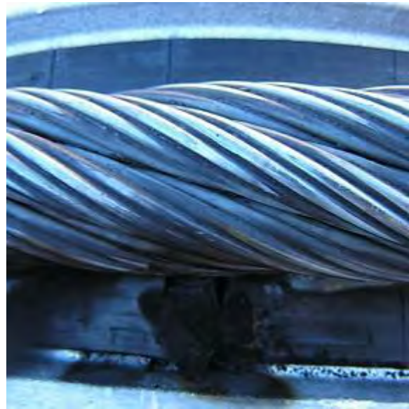
Photo 2.5 : Dommage causé par la circulation du courant
