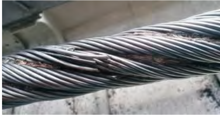
Photo 2.3 : Jointure affaissée présentant quelques ruptures de fils métalliques
