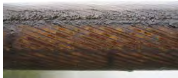
Photo 4.18 : Corrosion sur un câble clos
