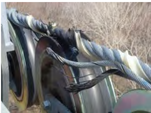
Photo 2.6 : Dommage causé par la circulation du courant
