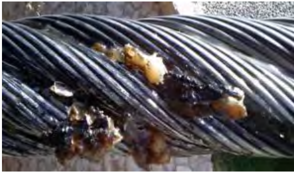
Photo 2.12 : Important défaut causé par la foudre sur un câble à torons
