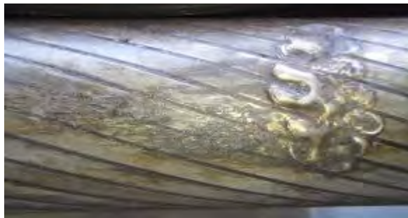
Photo 2.14 : Point d'impact sur la partie inférieure du câble
