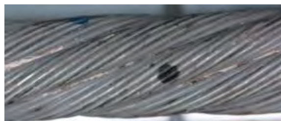
Photo 4.14 : Rupture de fils métalliques 0,5 x diamètre du toron
