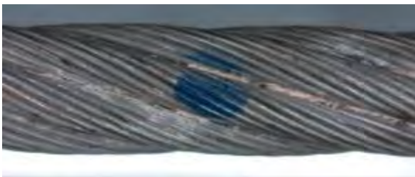
Photo 4.6 : Impact de foudre 1,0 x diamètre du toron
