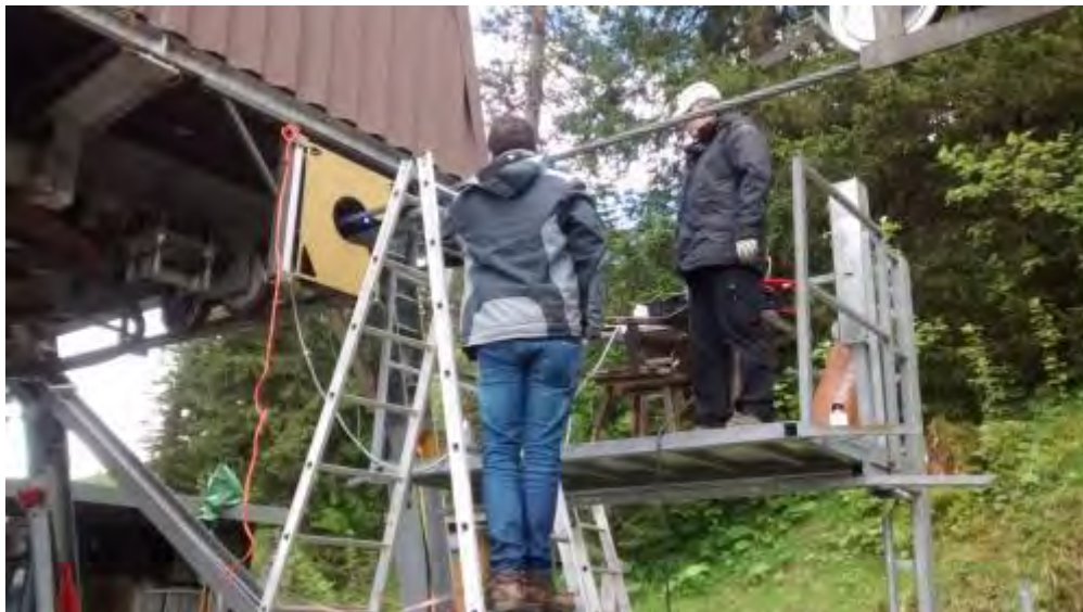
Photo 4.29 : Conditions sur le poste d'examen de la première installation
