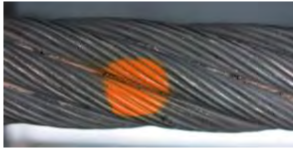
Photo 4.22: Corrosion 1,5 x diamètre du toron
