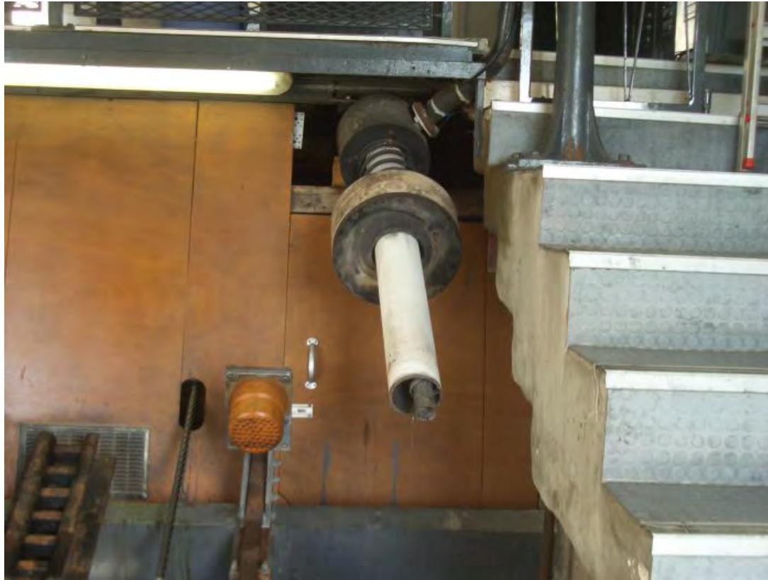
©Bloch09-Bergstation, Wasserfassung (Ballast)
