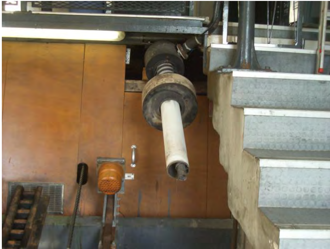
©Bloch09-Bergstation, Wasserfassung (Ballast)
