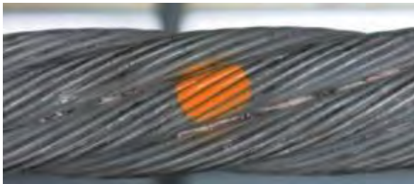
Abbildung 4.23: Korrosion 1 x Litzendurchmesser
