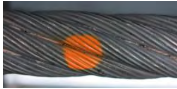
Abbildung 4.22: Korrosion 1,5 x Litzendurchmesser
