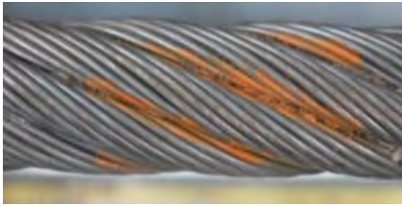
Abbildung 4.21: Korrosion in Litzengasse
