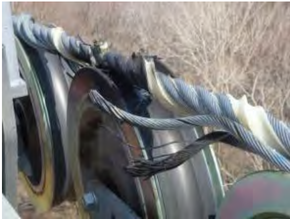
Abbildung 2.6: Schaden durch Stromfluss
