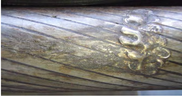
Abbildung 2.14: Einschlagstelle an Seilunterseite
