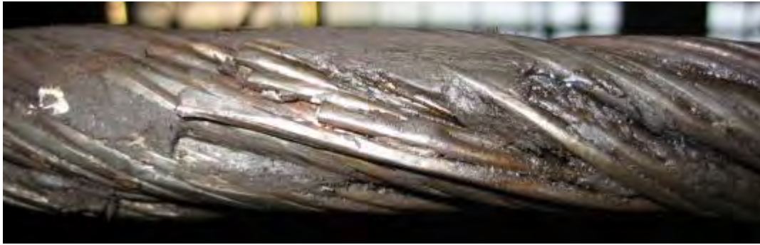
Abbildung 13: Verschmutztes Seil – Inspektion nicht möglich
