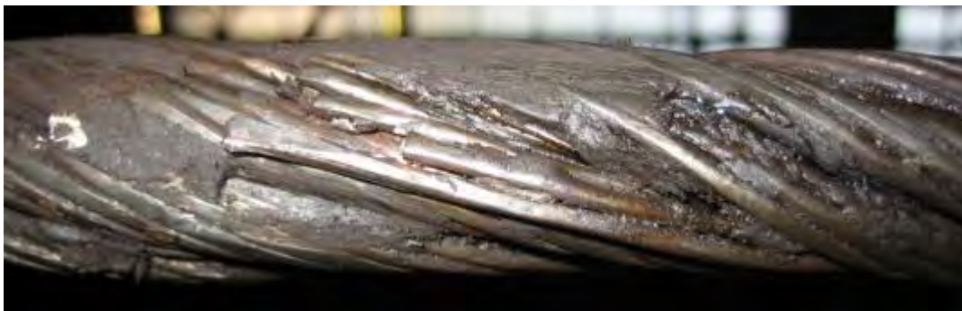
Abbildung 6.13: Verschmutztes Seil – Inspektion nicht möglich
