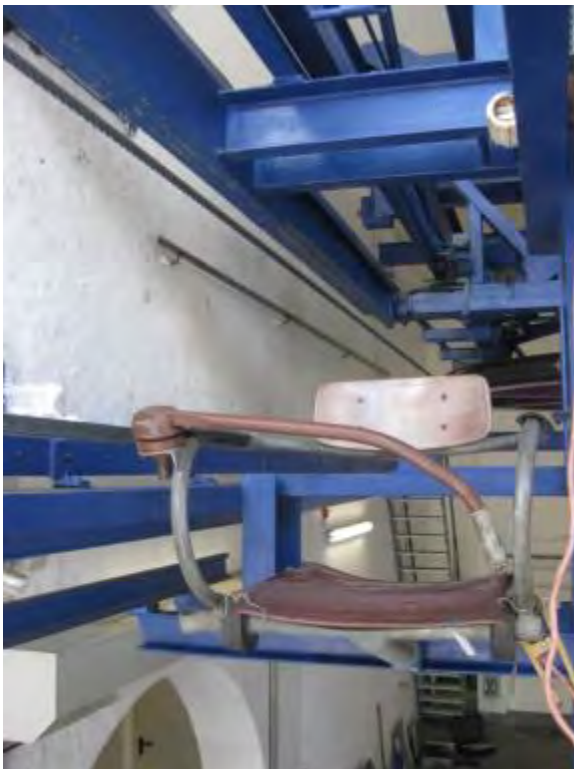
Abbildung 3.4: Prüfsitz an einer Anlage
