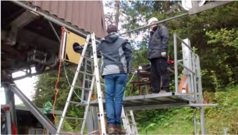
Abbildung 4.29: Arbeitsplatzbedingungen an der ersten Anlage
