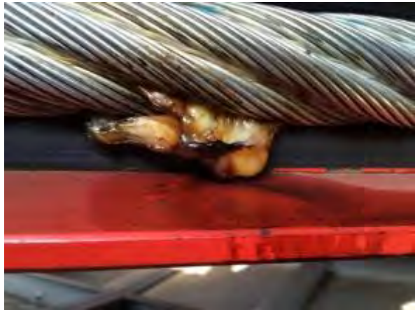
Abbildung 2.7: Schaden durch Stromfluss
