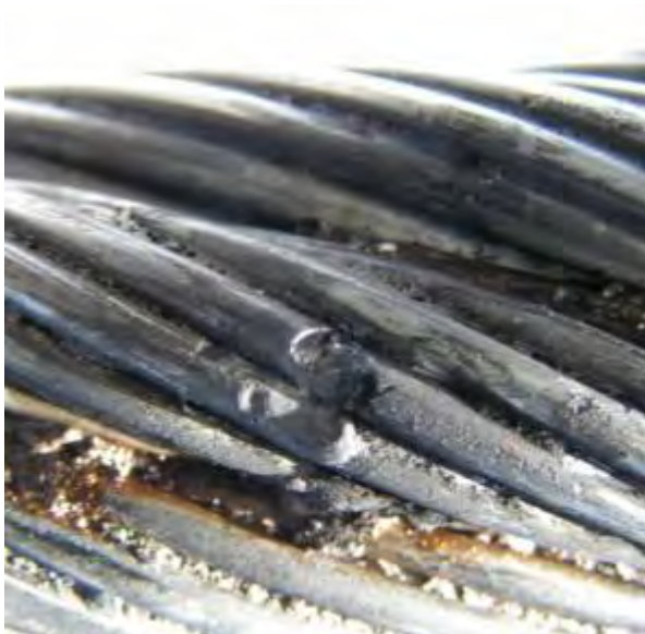
Abbildung 2.4: Schaden durch Stromfluss
