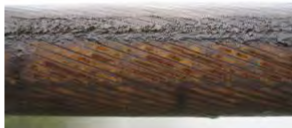
Abbildung 4.18: Korrosion bei einem vollver- schlossenen Seil
