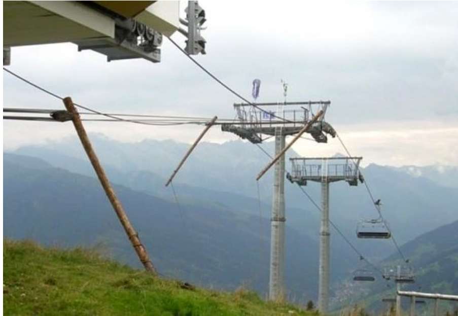
Abbildung 4: Drallknebelung beim Abspannen eines Förderseils (Quelle: seilbahnen-kogler.at)
