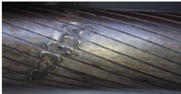
Abbildung 4: Einschlag-/Austrittsstelle an der Seite des Seils
