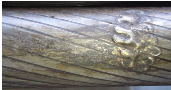
Abbildung 3: Einschlagstelle an Seilunterseite
