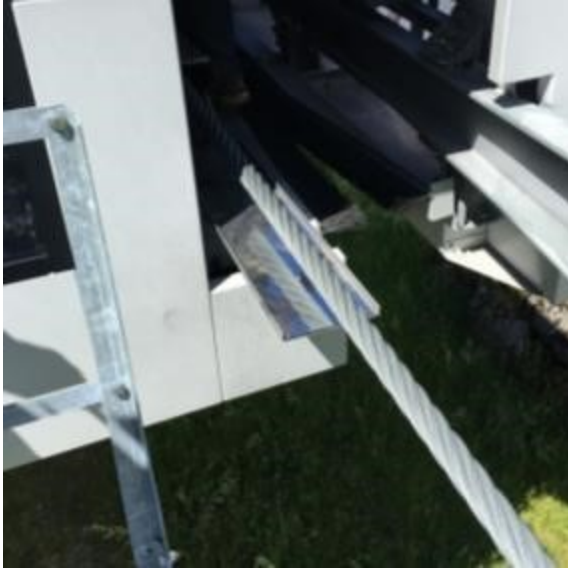
Abbildung 9: Spiegel an standardisierter Modulstation für Einseilumlaufbahnen (Blick von außerhalb der Station)
