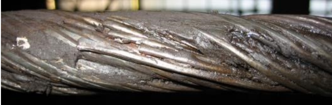
Abbildung 11: Verschmutztes Seil – Inspektion nicht möglich
