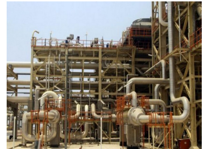
Des installations sur le site iranien gazier de South Pars en juillet 2010. (© AFP Atta Kenare)
